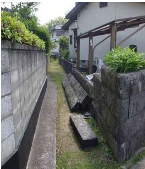
平成28年熊本地震における ブロック塀等の被害の実例
