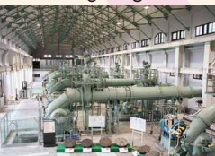
館内には10台の 巨大ポンプが残る
