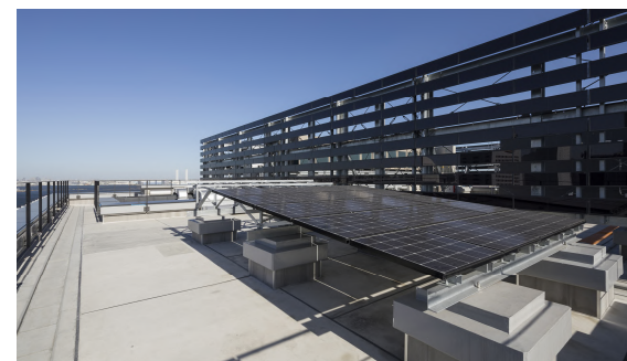
太陽光発電システム
