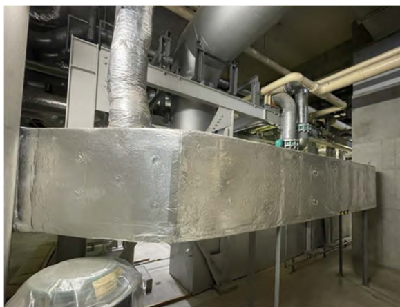
設備増設スペースの不足
