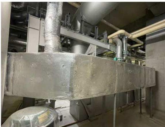
設備増設スペースの不足
